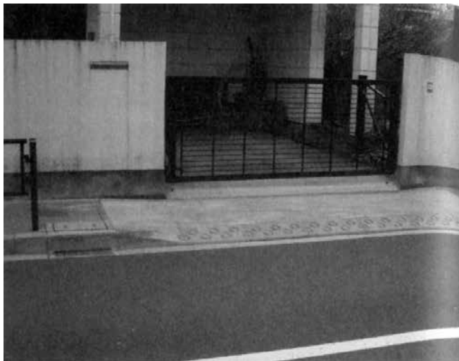
道路の段差と傾斜
